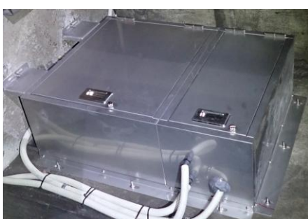
UPS電源モジュール
